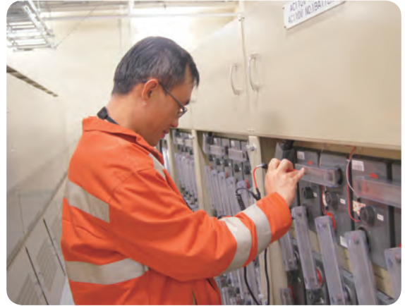
號誌專業訓練-機房設備確認
