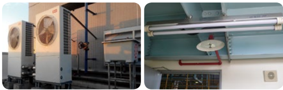
裝設小型冰水主機之獨立空調系統 採用節能燈具管控照明措施
