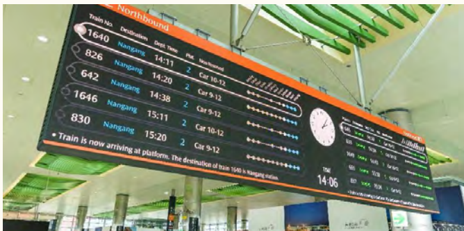
車站旅客資訊系統更新
